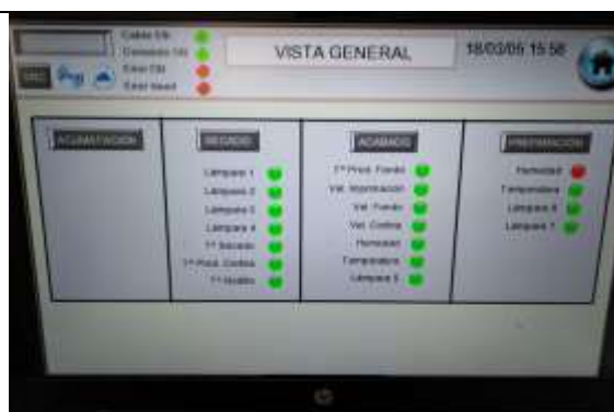
Vista general del sistema SCADA en el portátil
