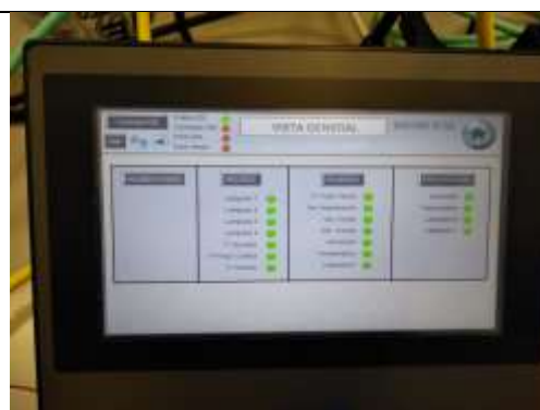
Vista general del sistema SCADA en la HMI
